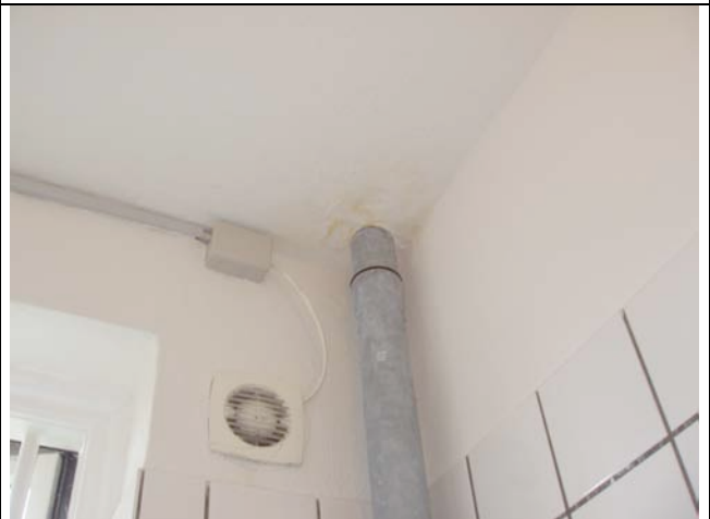
Afdeling O, bad til højre Misfarvning ved faldstamme – ingen vækst
