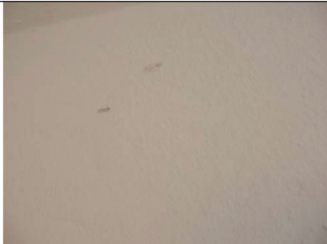
Skade på maling efter montering af ventilator – ingen vækst
